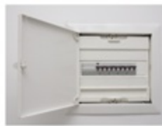
El contador eléctrico Electric meter
