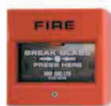
la alarma contra incendios fire alarm
