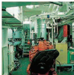
la sala de máquinas engine room
