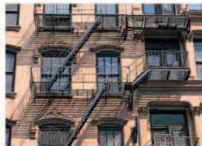
la escalera (la salida) de incendios fire escape
